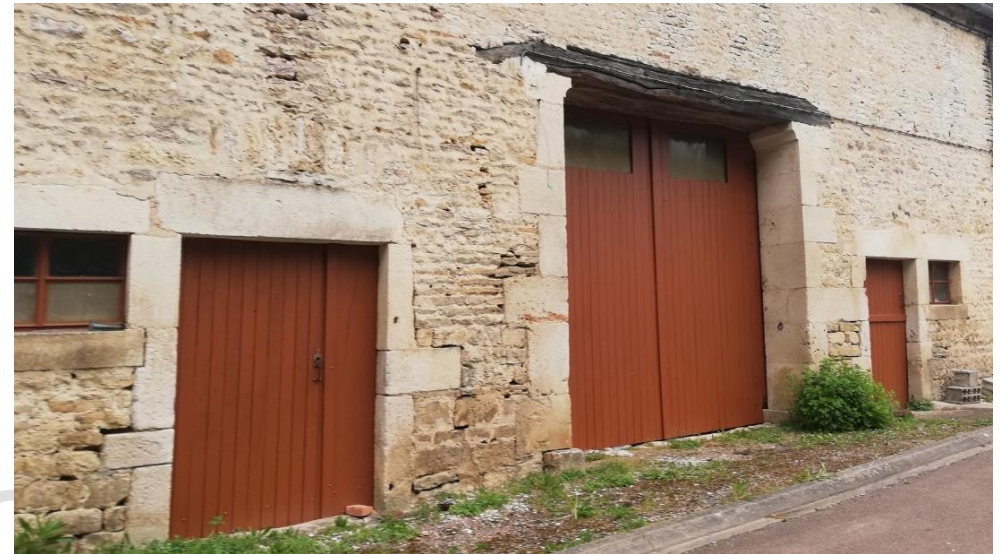
Pierre calcaire et mortier à la chaux, ainsi que chaînages en pierre de taille – Perrogney-les-Fontaines
