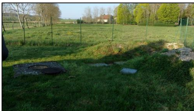
Premier bassin avec liaison siphonnée
