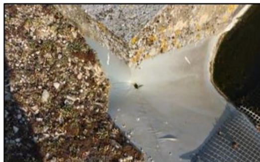
Poinçonnements / déchirements (bassin3)
